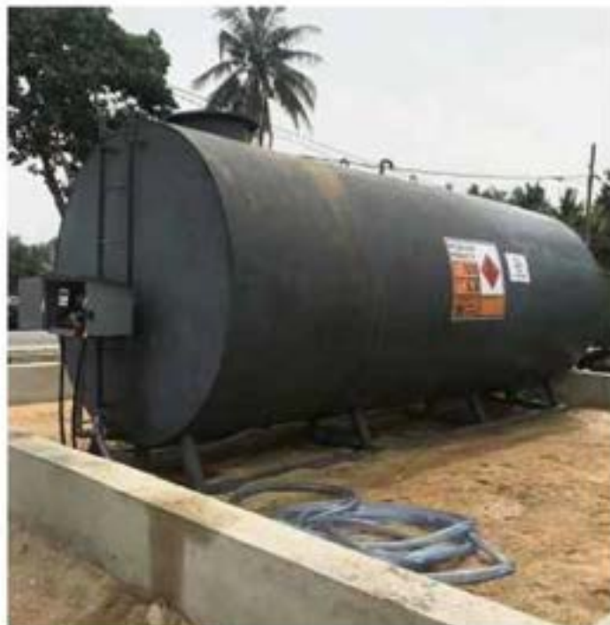
TANGKI skid menyimpan 25,000 diesel bernilai RM111,750 dirampas di tapak projek kawalan hakisan pantai di Kampung Mengabang Kapal, Kuala Nerus.
